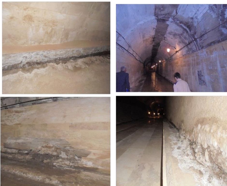
Расми 4.4. – Вайроншавии сатҳи бетонҳо дар қисматҳои девор ва сақфи нақби сохтмони №3
