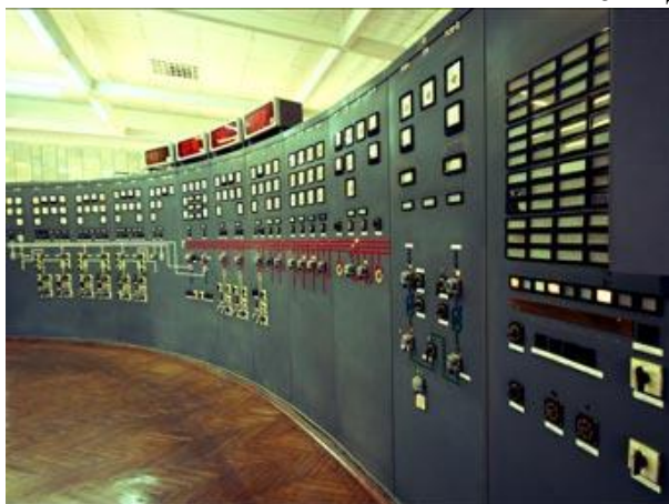
е – центральный пульт управления
