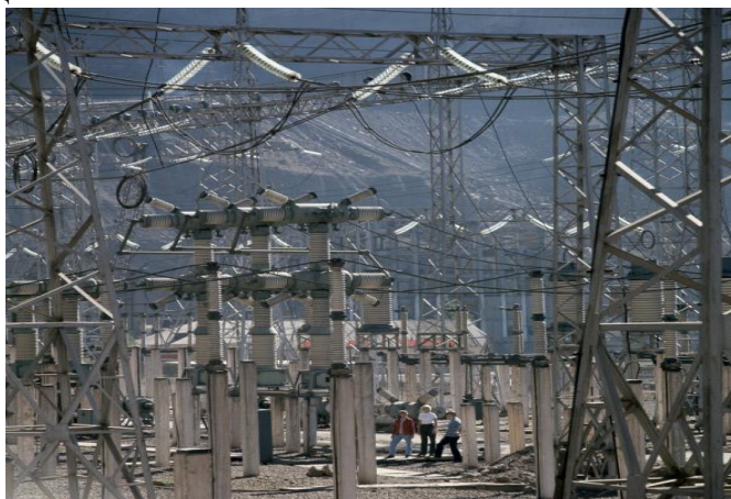
ж – открытое распределительной устройство ОРУ-500
